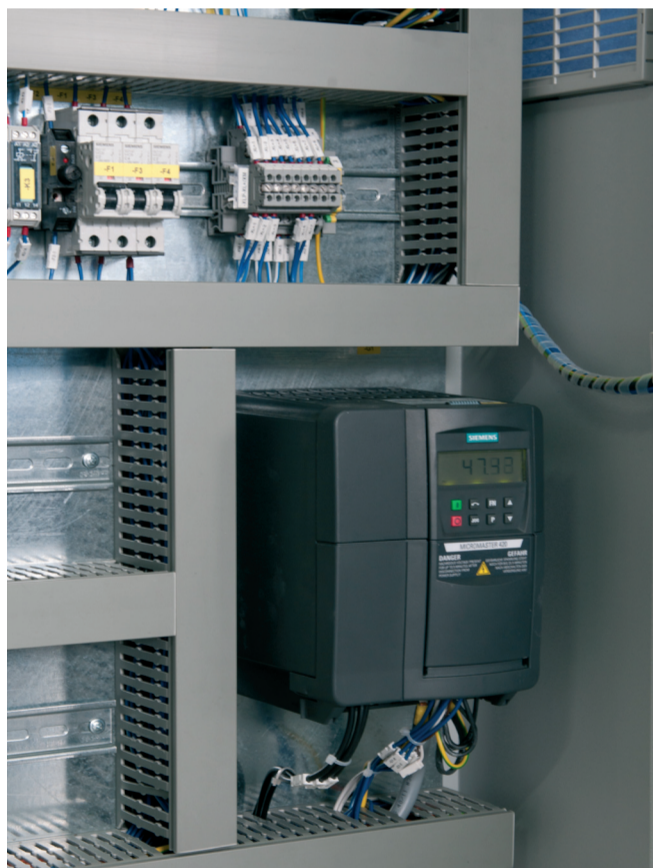
(Bild 3) Ein Frequenzumrichter sorgt für den richtigen Regenerationsluftvolumenstrom bei konstanter Regenerationslufttemperatur.
